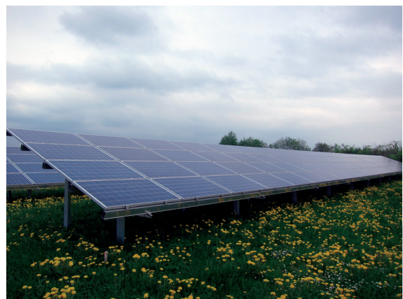
Photovoltaik – Freifläche Odenwald 444,62 kWp
